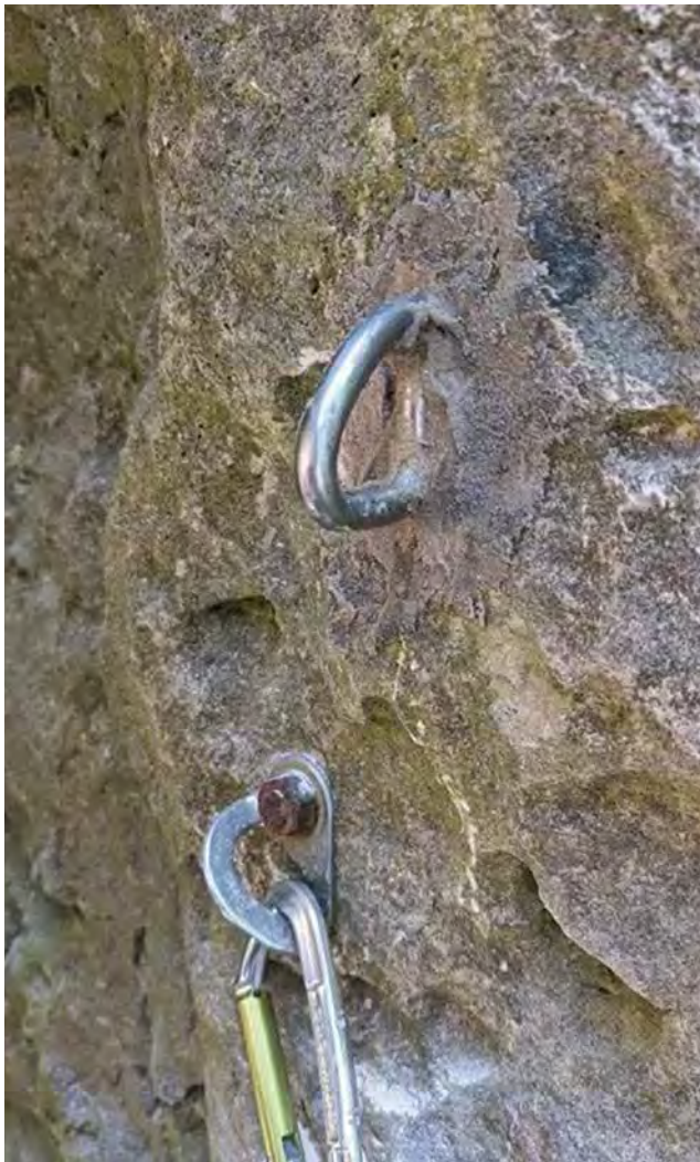
Korrodierte Gewindestange mit Lasche
