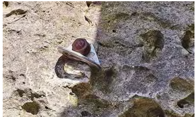
Korrodierte Gewindestange mit Mutter
